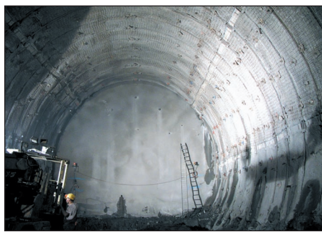
Section du tunnel du Lötschberg en zone houillère avec des HDC-Éléments de type poutre (Solexperts, 2004)
