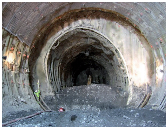
Photo 5 - Déformation de la section
